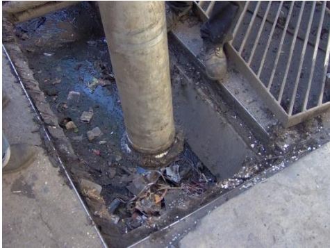
Obstrucción de alcantarillas
