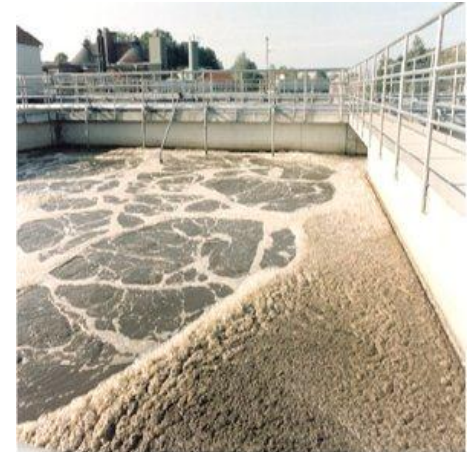
Alteraciones en la depuración (Foaming)
