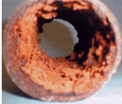
Corrosión de tuberías
